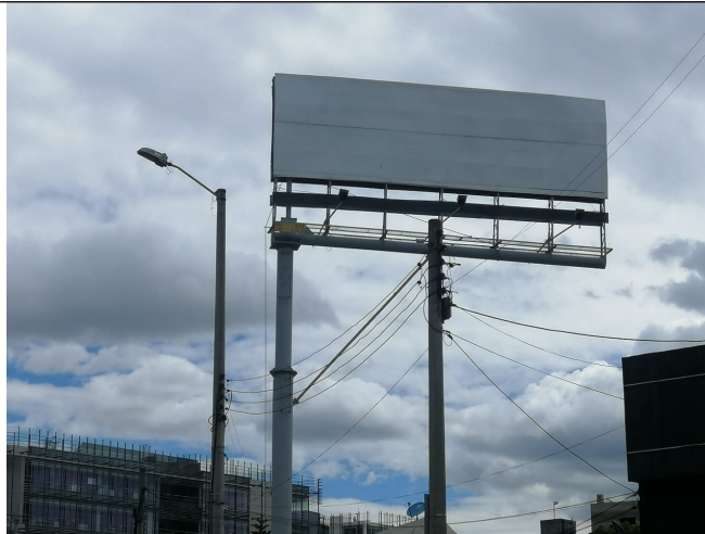
Foto 2. Vista del panel orientación NORTE-SUR y de la estructura de la valla, en buenas condiciones y estable.
